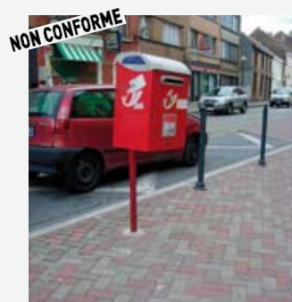
Potelets anti-stationnement non conformes, car ne respectant pas le § 4.
