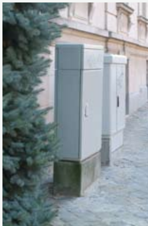
Position conforme des armoires des concessionnaires.
