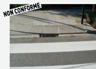
Position non conforme de l'avaloir, car situé au droit de la traversée piétonne.
