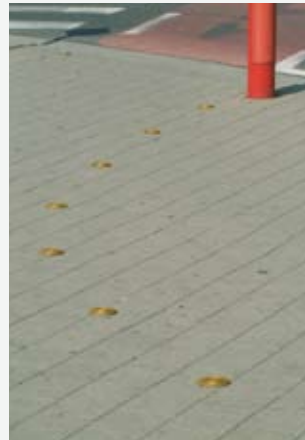
Dalles podotactiles à l'approche d'un mobilier urbain non prolongé jusqu'au sol.
